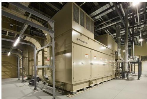
停電時も発電可能なガスコージェネレーションシステム
