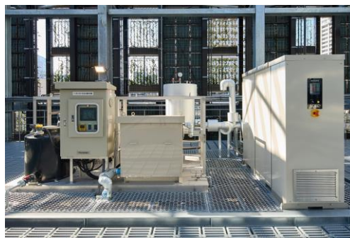
高効率燃料電池システム FC-6MとCCU装置
